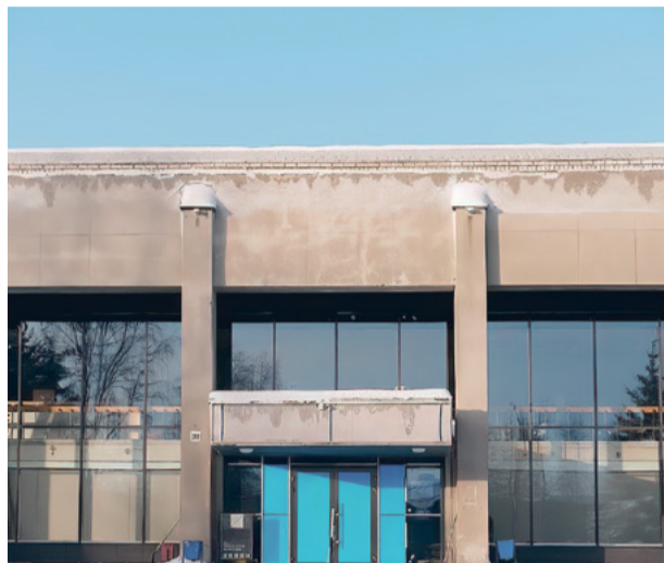
Так выглядел фасад до ремонта
